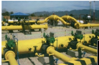
Gasoducto Integración Juana Azurduy
