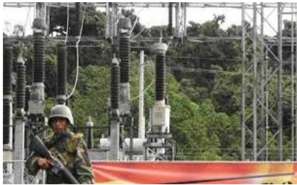
1. Plan Emergencia para el Abastecimiento de Electricidad al SIN (Trinidad, San Bernardino de Yucumo): Bs157 MM Gestión 2011
